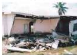
ハリケーンの直撃により破壊された家屋 (ホンジュラス)
